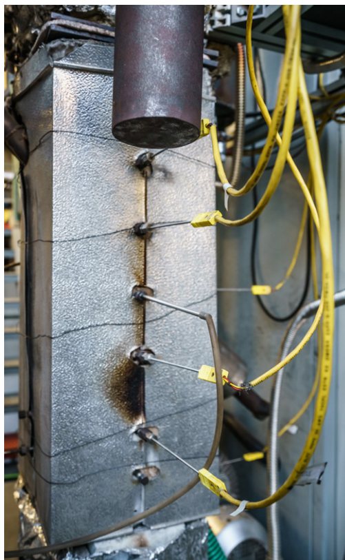
Teplotní čidla spalovací komory
